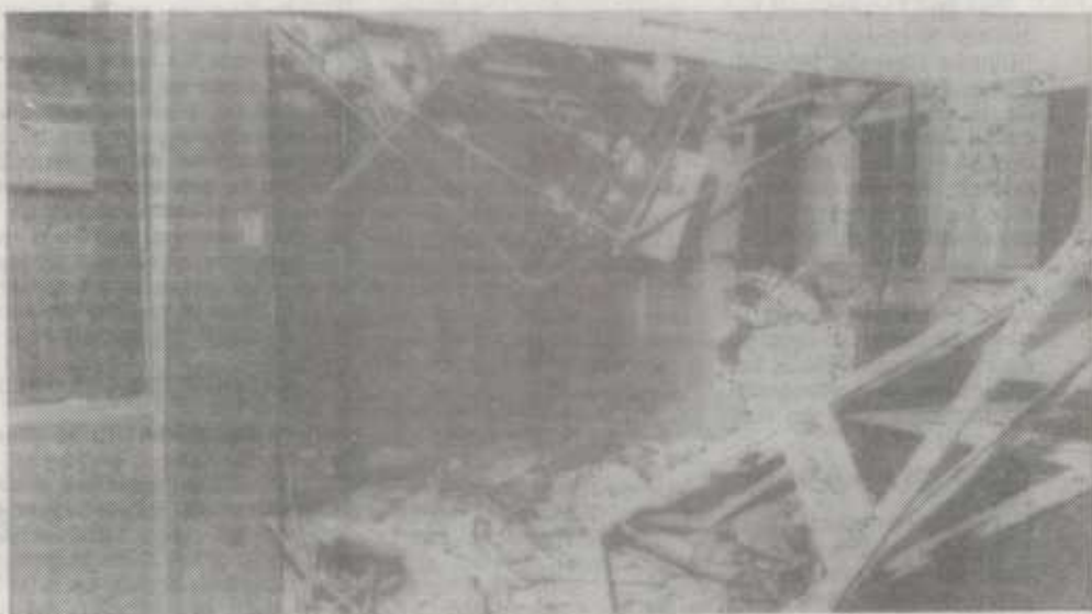
Aspecto de la planta baja, completamente destruida tras la explosión, que afectó, asimismo, a varios pisos y vehículos estacionados en el exterior. (Telefoto EFE)
