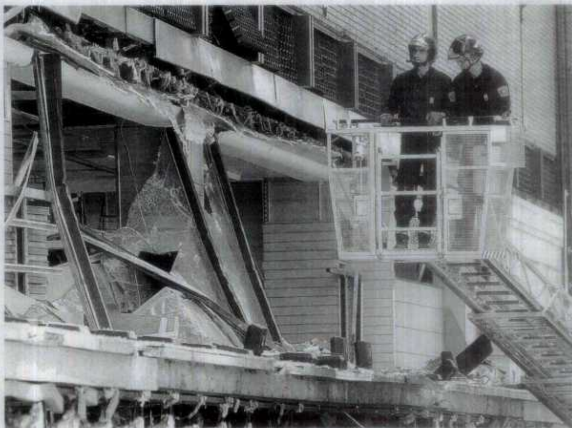
VENTANAS ROTAS. Dos bomberos inspeccionan los destrozos en la fachada de un edificio. / EFE
