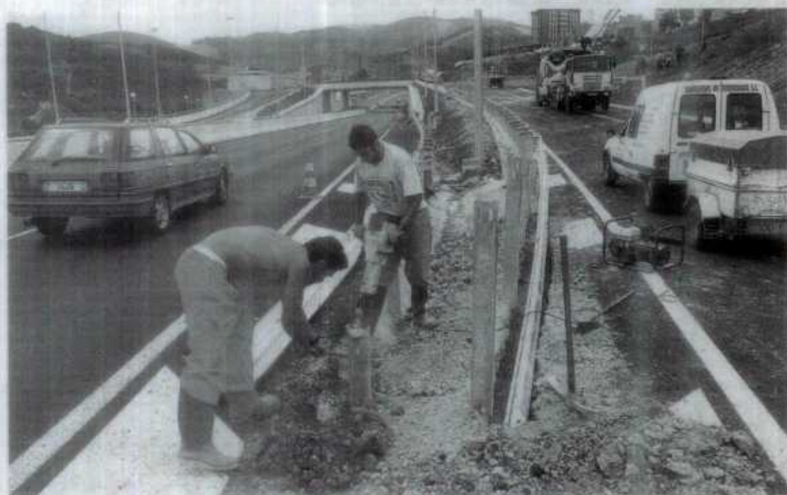
Dos operarios rematan el vallado en la variante de Otxarkoaga. / JOSÉ MARI LÓPEZ
