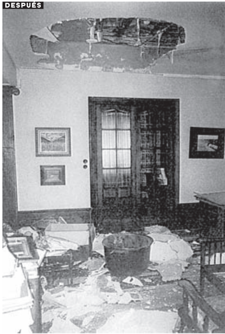
LAS HUMEDADES provocaron la caída del techo del salón el 15 de febrero, entre otros daños en el piso de los afectados. / EL CORREO
