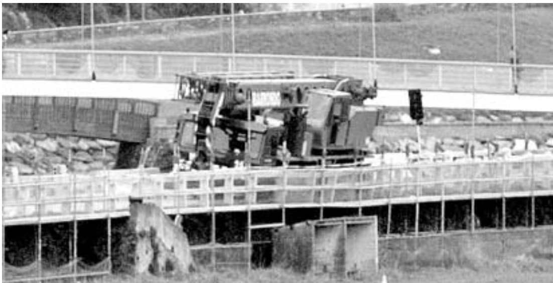
INMOVILIZADA. La grúa trabajaba en una pasarela peatonal de Plentzia. / LUIS CALABOR
