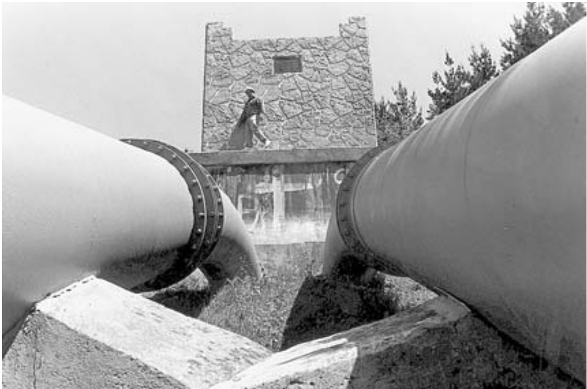
LA TUBERÍA GENERAL recorre más de 40 kilómetros entre Ordunte y Bilbao. / FERNANDO GÓMEZ
