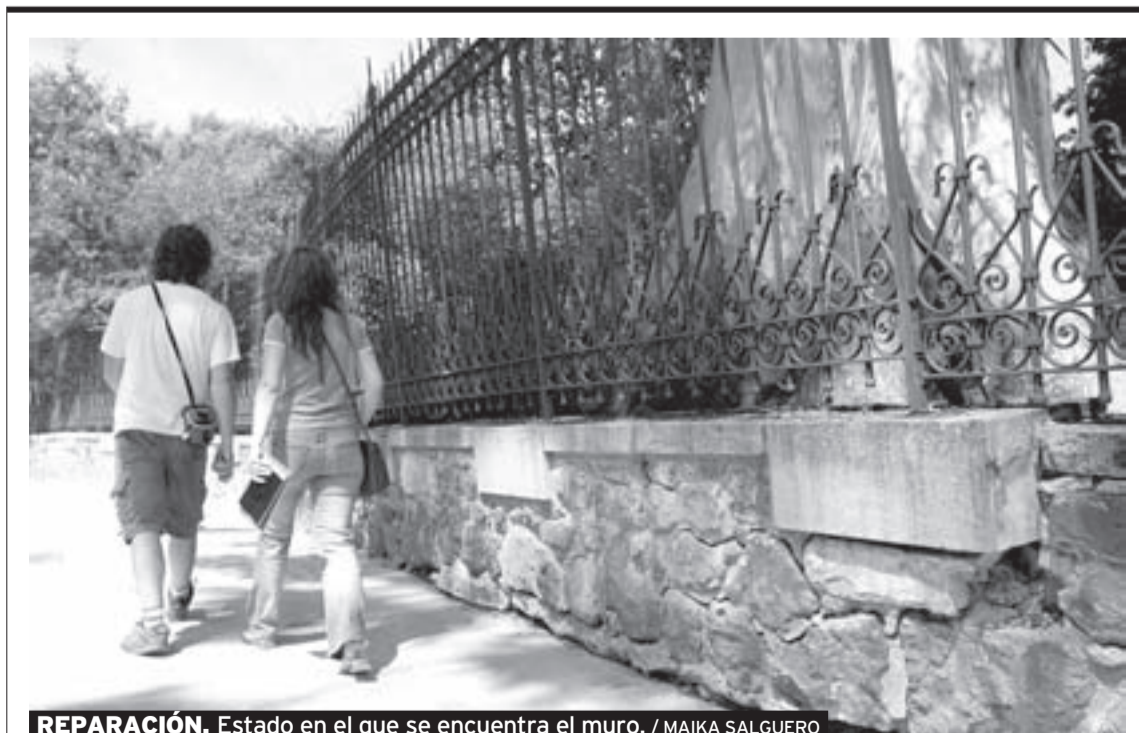
REPARACIÓN. Estado en el que se encuentra el muro. / MAIKA SALGUERO
